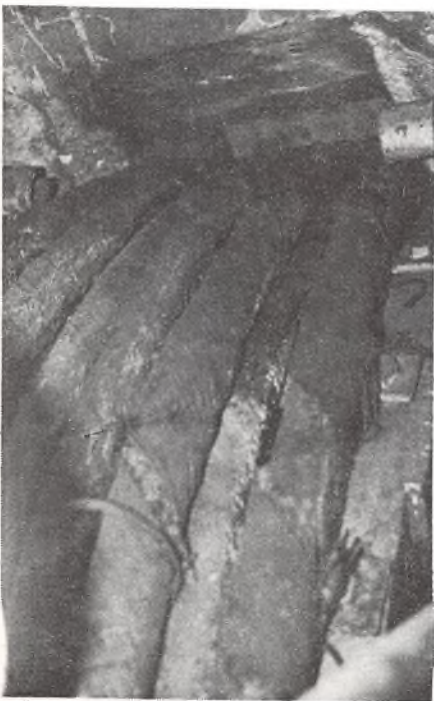
Door pekels geoxydeerde kabels
