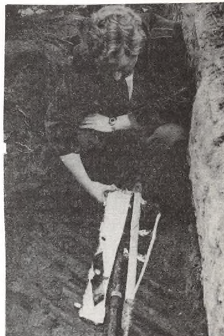
Foto boven: Onder de kabels de LPG-gastoevoerbuizen.
